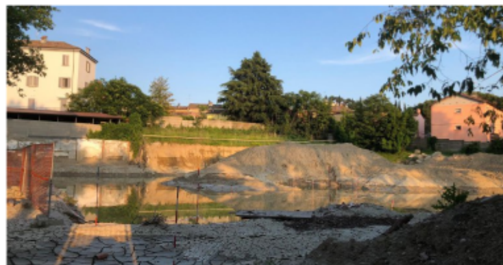
Sopra Paolo Lucchi, sotto il cantiere del nuovo commissariato al Caps ridotto ad uno stagno
